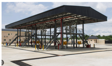
Eksempel på truckloadinganlæg.
